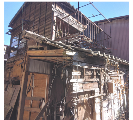
倒壊寸前の空家
