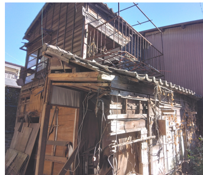
崩壊寸前の空家（若宮地域）
