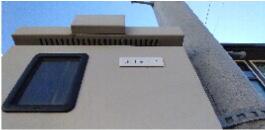
八幡地区の雨水排水ポンプは作動していた（写真上）
