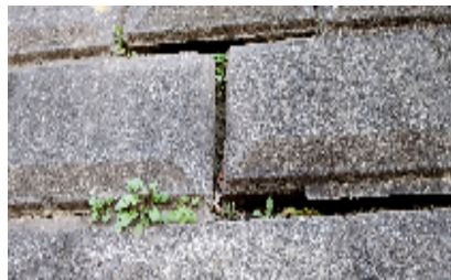
斜面石垣の割れ目拡大
